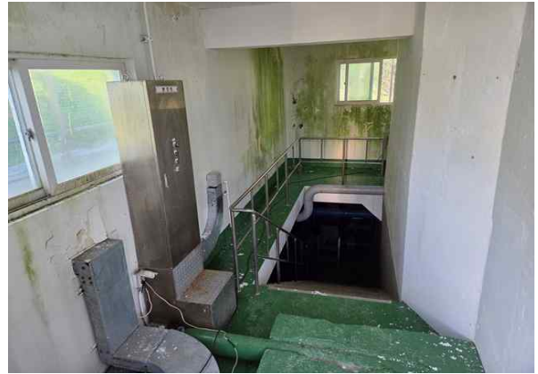
배관검수실 내부 전경
